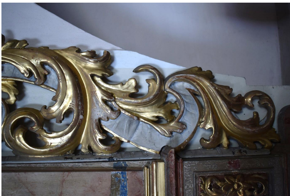
Štarnov, kostel sv. Mikuláše, kazatelna: detail horní části dekorace stříšky (špatně přístupné-bez sondy) dá se předpokládat dochování původních vrstev pod silným nánosem především poslední sekundární úpravy. Detail stavu řezby za řečništěm (mechanická poškození zlacení).
