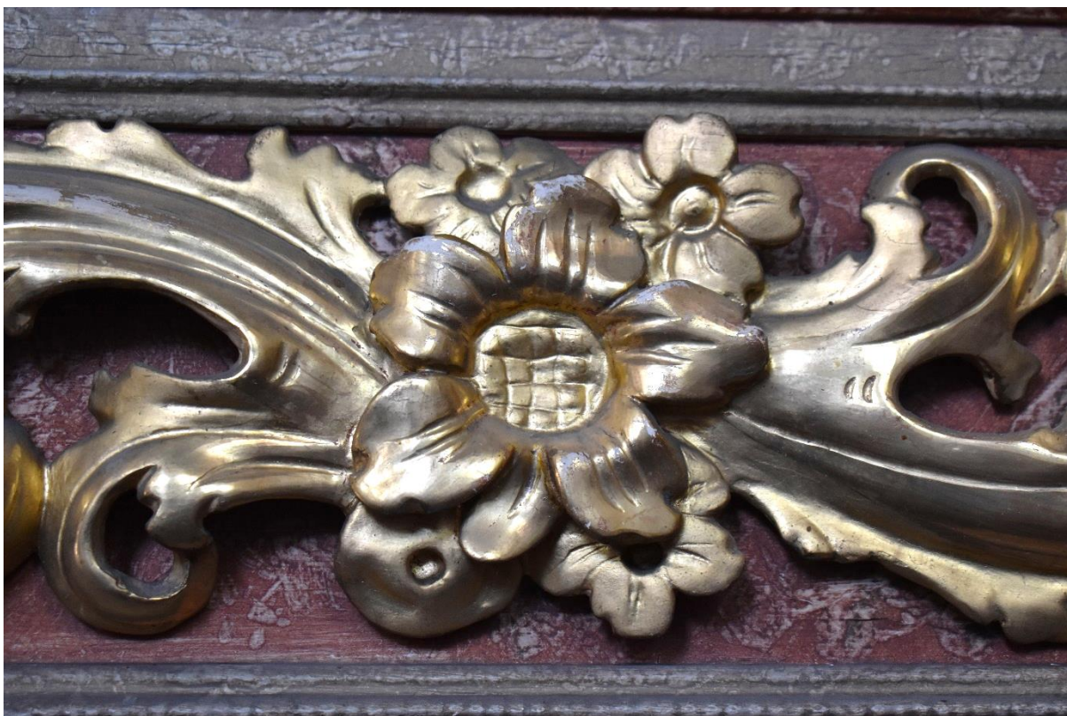
Štarnov, kostel sv. Mikuláše, kazatelna: ukázka některých poškození
