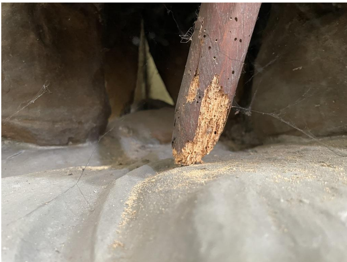
Obr. č. 11 Současný stav oltáře, detail poškození aktivním dřevokazným hmyzem - červotočem.
