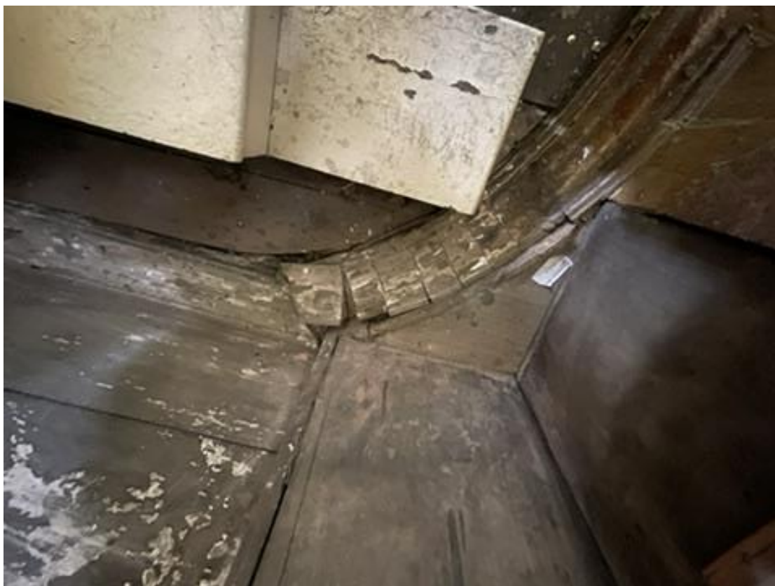
Obr. č. 2 Současný stav oltáře, celkový pohled, detail poškození architektonických částí, ztráty původních částí.
