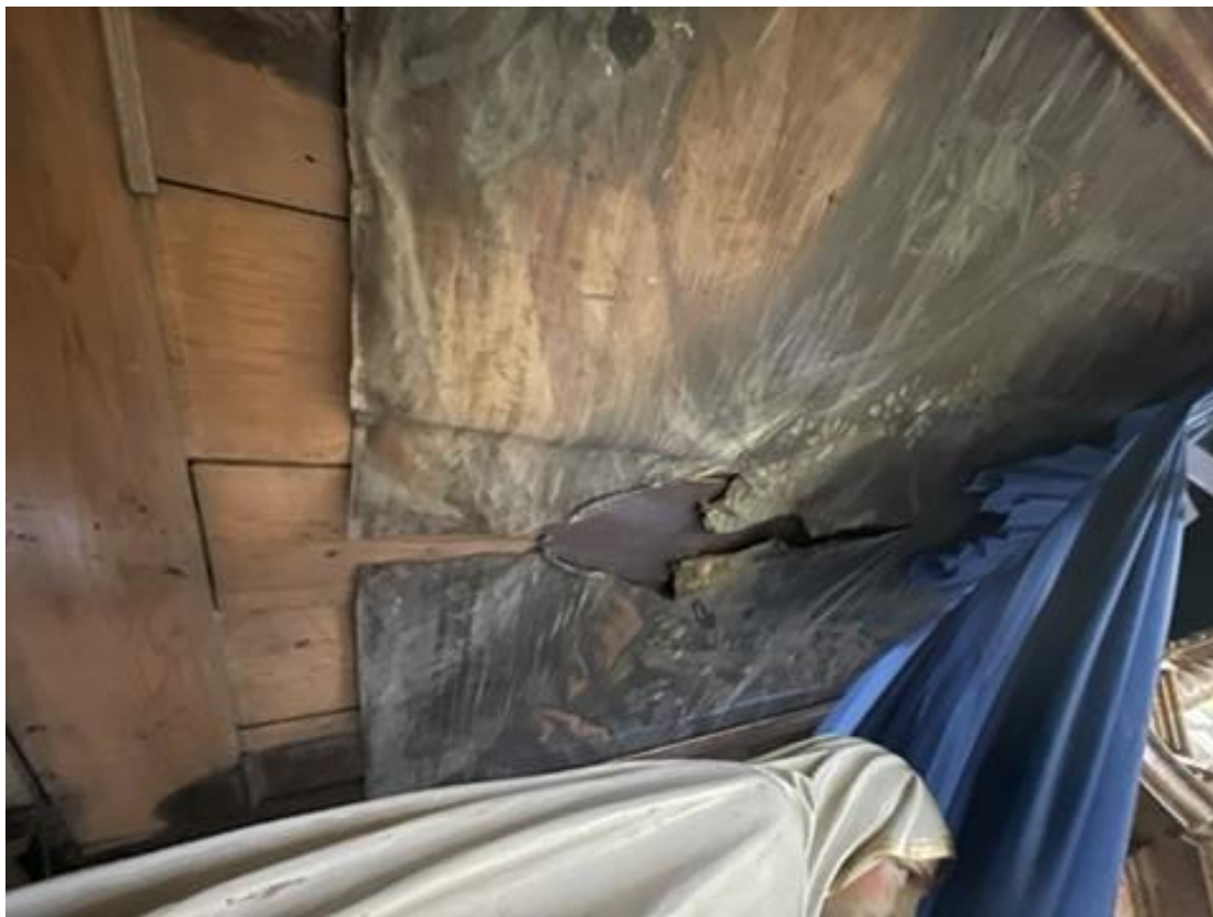
Obr. č. 6 Současný stav oltáře, detail poškození plátna osazeného v původním místě hlavního obrazu.
